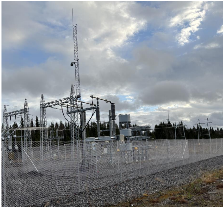
Mynd 2: Tengivirki og háspennulína sem wpd reisti í Finnlandi fyrir virkjun í Pyhäjoki.
